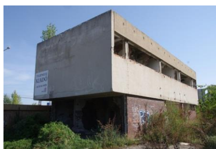
6.7. ábra. Az 55-ös út melletti egykori téglagyár elhagyott, pusztuló épülete kívülről és belülről (fotó: Karancsi Z.)
